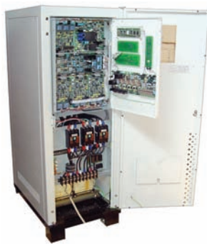
Внутренняя компоновка устройства
