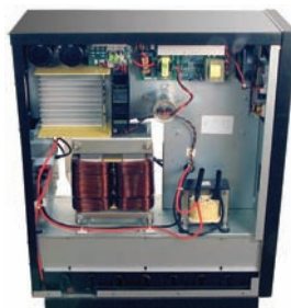
Изолирующий трансформатор, аккумуляторные батареи снизу в лотке
